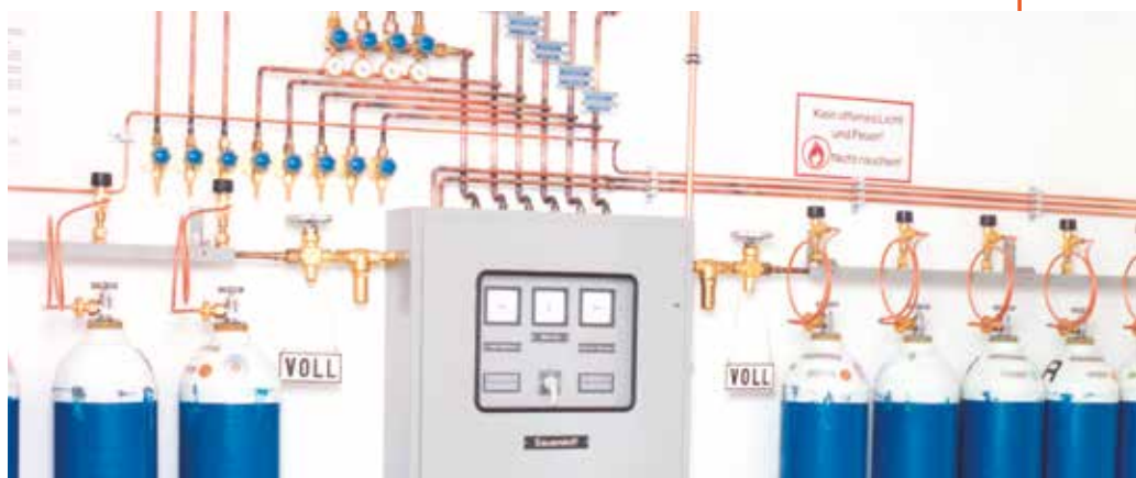
Obr. č. 8 Rozvodná stanice (Drägerwerke)
